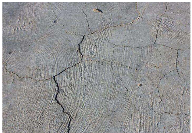
图1 骨料反应引起的混凝土裂缝
